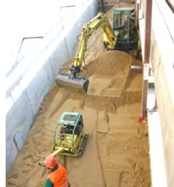
Der Ammann Yanmar Hüllkreisbagger ViO 45 aus dem HKL MIETPARK ist besonders in beengten Verhältnissen, wie hier auf der Kemmer-Baustelle am Holzhafen in Hamburg, in seinem Element.
