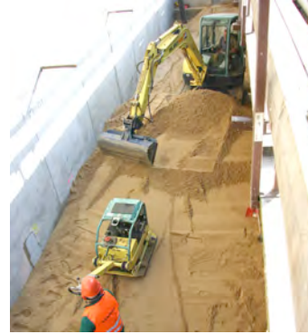
Der Ammann Yanmar Hüllkreisbagger ViO 45 aus dem HKL MIETPARK ist besonders in beengten Verhältnissen, wie hier auf der Kemmer-Baustelle am Holzhafen in Hamburg, in seinem Element.
