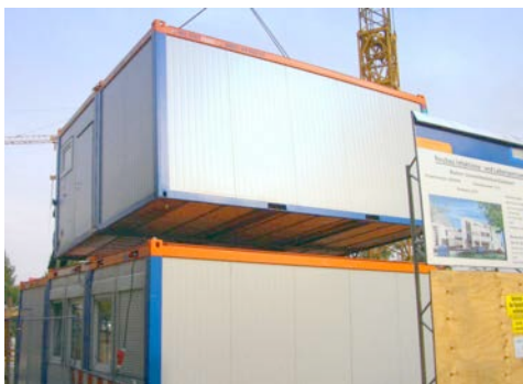
HKL Containereinheiten dienen während des Neubaus des Düsseldorfer Infektions- und Leberzentrums als Büro- und Aufenthaltsräume.
