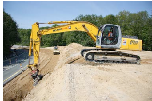
Bagger und Walzenzüge aus dem HKL MIETPARK unterstützen die Arbeiten an der A 39 / A 391.
