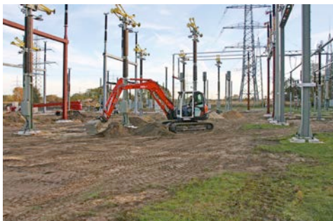
Bagger aus dem HKL MIETPARK im Einsatz bei der Erweiterung eines Umspannwerks in Gütersloh.
