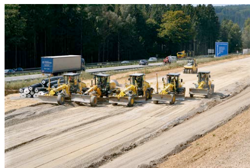
Grader aus dem HKL MIETPARK mit versiertem Bedienpersonal garantieren exakte Planumsarbeiten beim Ausbau der A8 Ulm-Augsburg-West.
