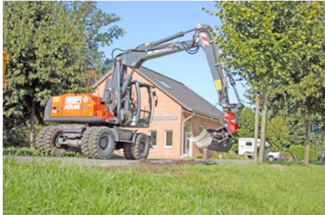
Feinfühliges Arbeiten bei gleichzeitigem Fahren: Bankett-Erneuerung mit dem Atlas 160 W aus dem HKL MIETPARK.
