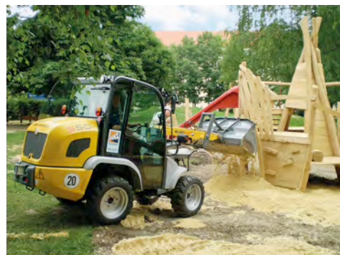
Ein Radlader aus dem HKL MIETPARK verteilt 60 Tonnen Sand auf dem neuen Spielplatz.
